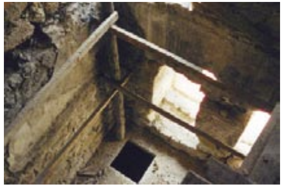
307. Resim: Suluhan, doğu kanattaki bir odanın restorasyonda betonarmeye dönüştürülmüş olan zemin kat düşmesi
