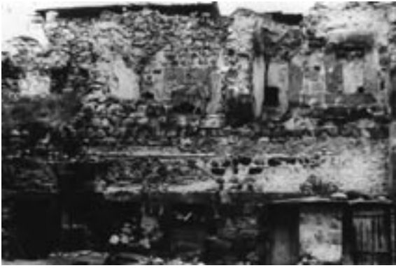
289. Resim: Suluhan, avlunun doğu kanadının kuzeyindeki üst örtüsü çökmüş olan birinci kat odalarından görünüşü, 1976 (VGM Arşivi'nden)
