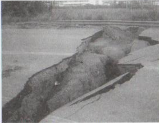
TEM yolundaki çatlak, Sapanca. * Kandilli Rasathanesi
