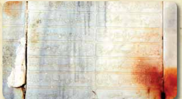
Fotoğraf 10: Ali Haydar Bey'in batıdaki taş kapının dış yüzünde yer alan ve pas nedeniyle çatlayan kitabeleri. Kitabedeki kahverengi renkli bölüm, pas lekeli olup müdahale edilerek kitabe koruma altına alınmazsa muhtemelen kırılacak bölüm olacaktır.
